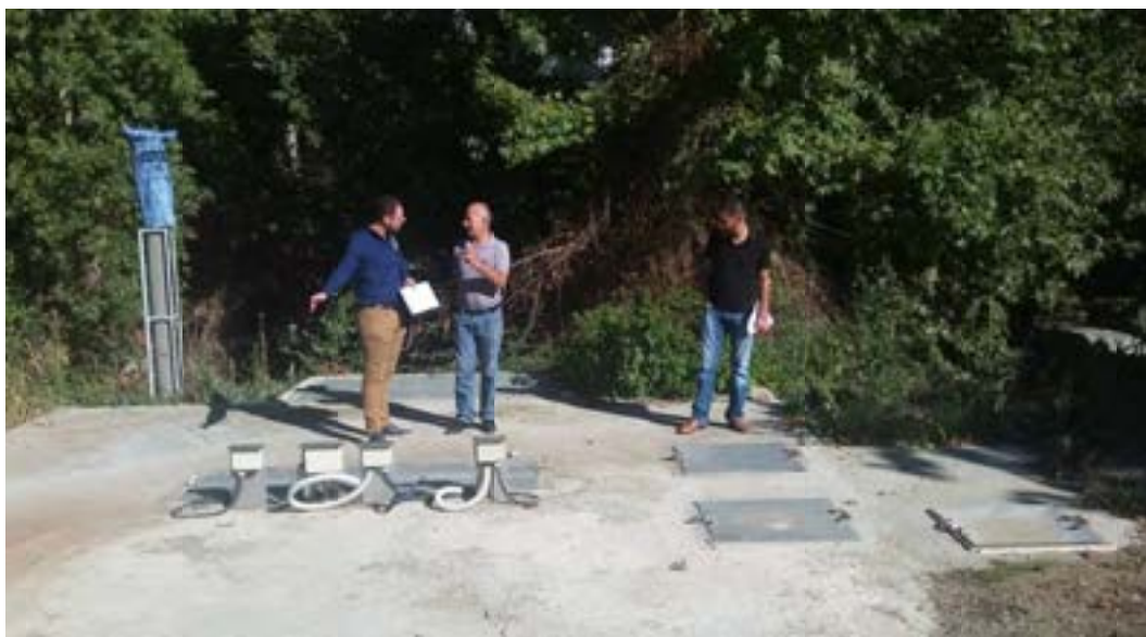
Εικόνα 14: Κεντρικό αντλιοστάσιο δικτύου στο Παλαιχώρι
