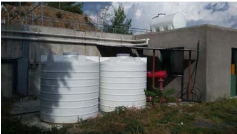
Εικόνα 13: Δεξαμενές επεξεργασμένου νερού στον ΣΕΛ Πάνω Πλάτρης
